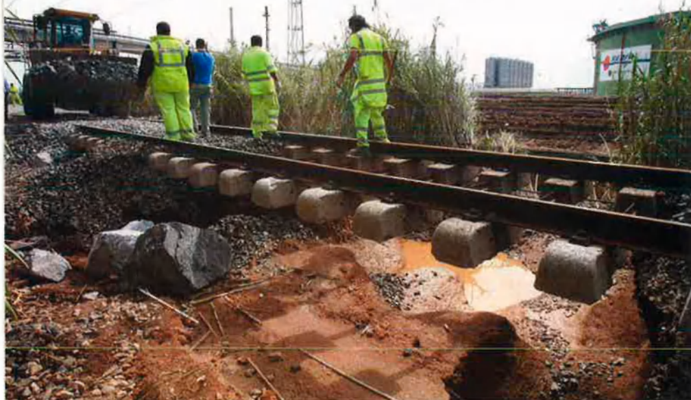
Un grup d'operaris camina sobre el tram de la plataforma de les vies ferroviàries que es va endur la riuada a l'altura de Tres Camins, entre Salou i Tarragona.
