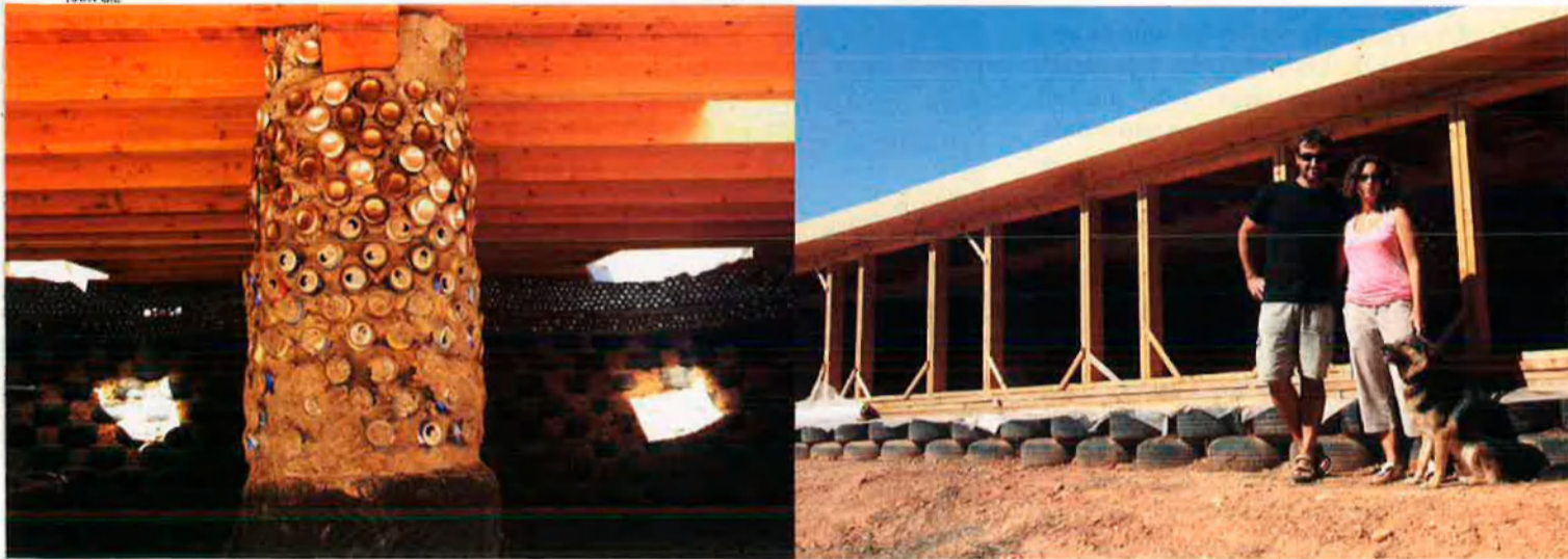
Els intestins de la casa: llaunes, pneumàtics i ciment. Òscar i Lisa davant de la construcció major. On són ells, hi haurà més endavant les plantes de la cèl·lula botànica exterior.
