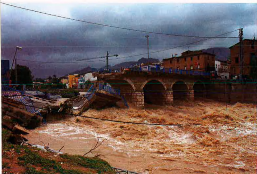
La força del riu Girona esfondrà el pont que uneix les dues parts de Beniarbeig.
