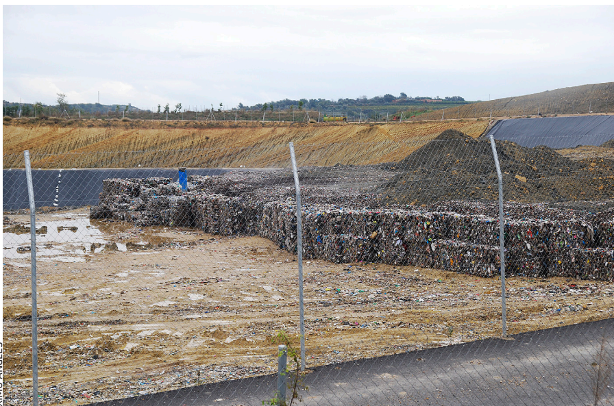
Una perspectiva de la planta de residus de Cervera del Maestre (Baix Maestrat), gestionada per tres empreses.
